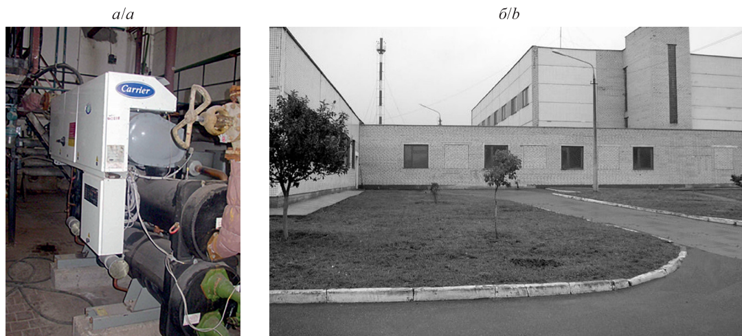
Рис. 14. Тепловой насос (а) и отапливаемый им комплекс сооружений канализационной насосной станции № 24 в д. Новый Двор Минского района (б). Источник: [17]
