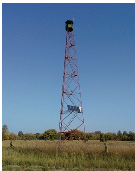
Рис. 2. Фотография ПРМВК, оборудованного солнечной электростанцией Fig. 2. Photograph of a radiation-meteorological and video control post equipped with a solar power plant
